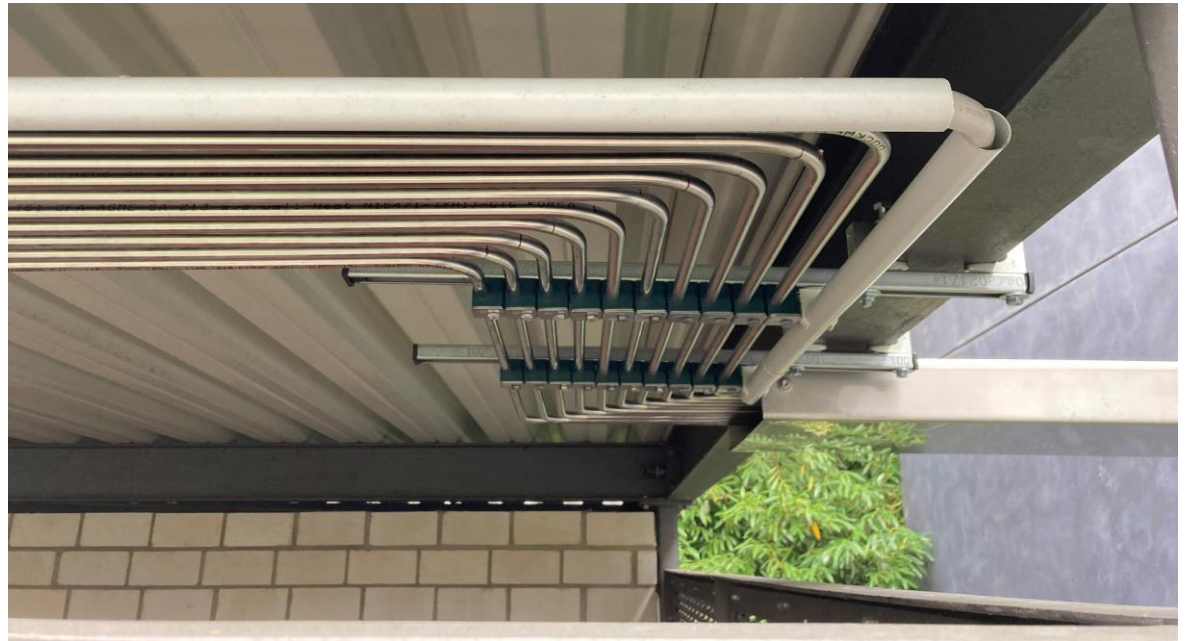
Zentrales Gaslager IOB
