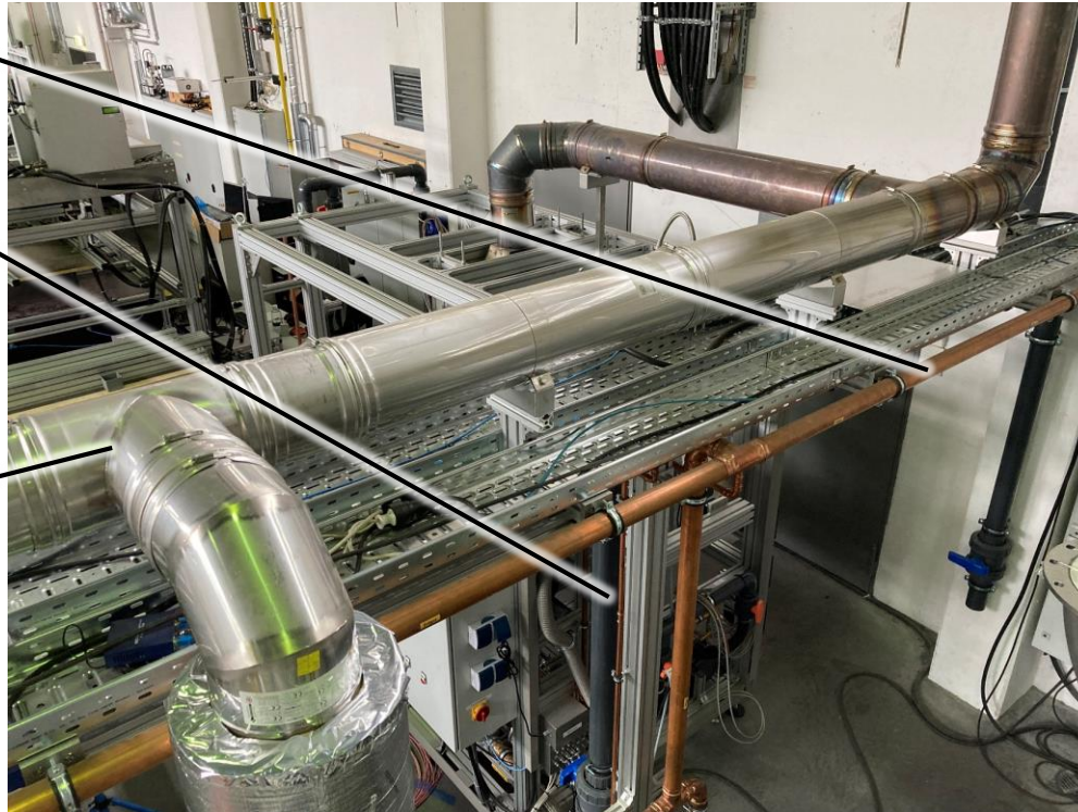
Zentrale Medienversorgung am Projektstand Tailored Heating
